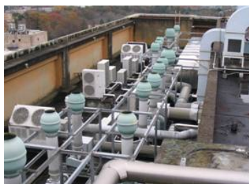
ドラフト屋外排気筒
