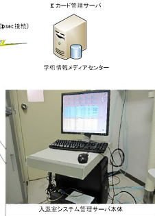
入退室システム管理サーバ本体
