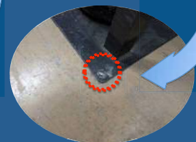
ポンベスタンド(床固定)
