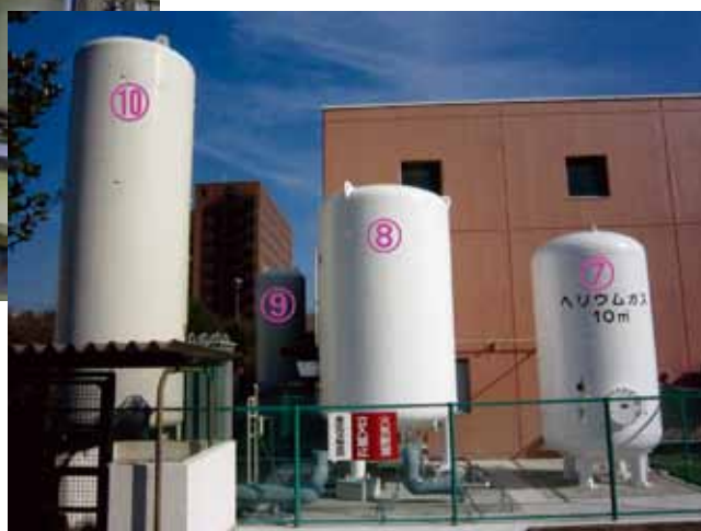
図4. バッファータンク・液体窒素貯槽
