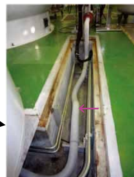
図5. フレキシブル回収配管
