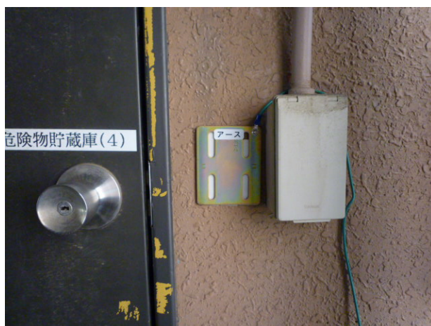
図9. 設置したアース端子
